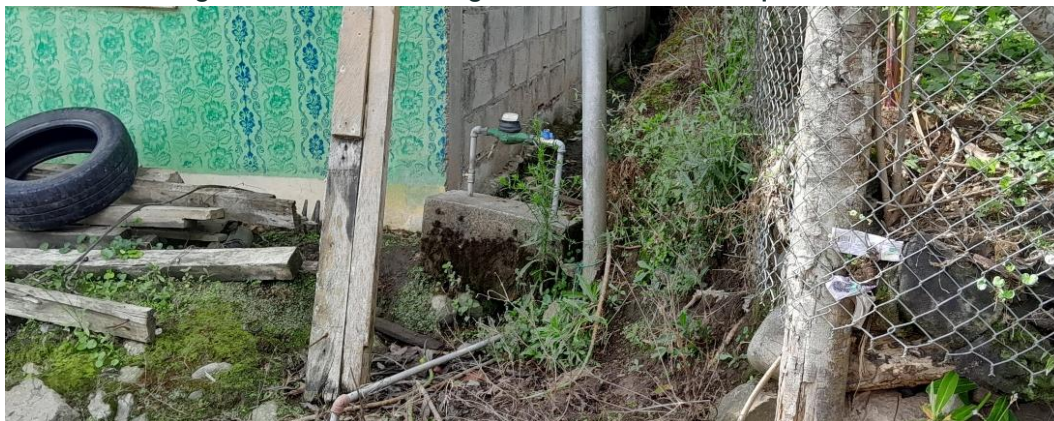
Fotografía 59. Medidor de agua en la vivienda Parroquia de Zuñac.
