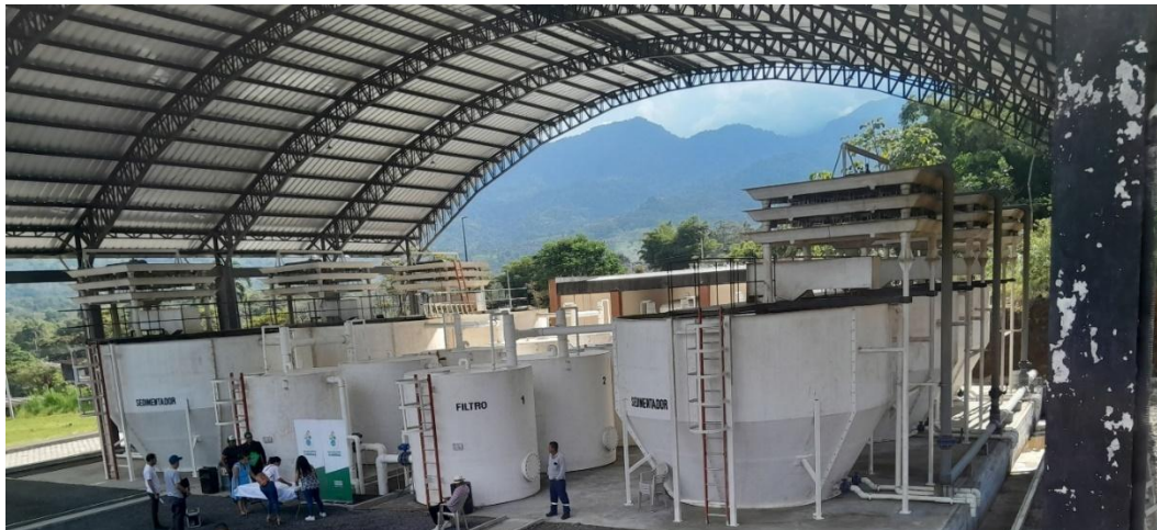
Fotografía 54. Planta de Tratamiento de Jimbitono
