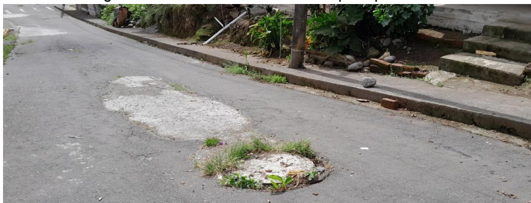
Fotografía 60. Pozo de alcantarillado centro parroquial de Zuñac.
