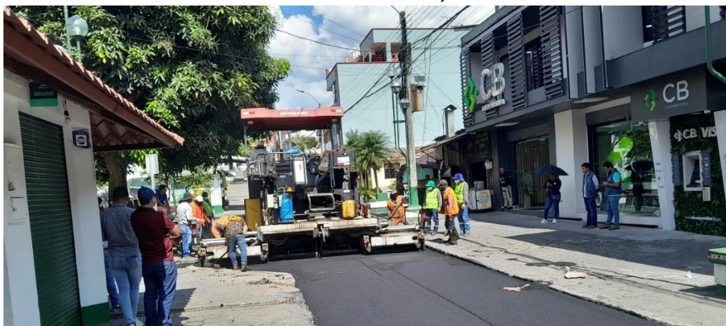
Fotografía 18. Pavimento flexible de la avenida Domingo Comín, entre la avenida Soasti en dirección a la avenida 24 de Mayo.
